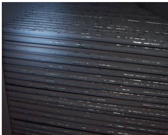
Рисунок 6. Состояние теплообменных трубок ПГВ-213 энергоблока № 2 РАЭС (введен в эксплуатацию в 1981 году, химическая отмывка не проводилась)
