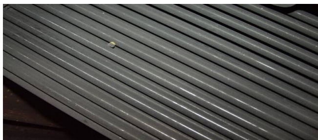
Рисунок 7. Состояние теплообменных трубок ПГВ-1000М энергоблока № 3 РАЭС (введен в эксплуатацию в 1986 году, химическая отмывка проводилась периодически в 1998 -2007 гг.)
