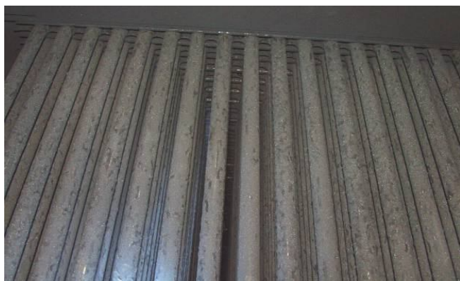
Рисунок 5. Состояние теплообменных трубок ПГВ-213 энергоблока № 1 РАЭС (введен в эксплуатацию в 1980 году, химическая отмывка проводилась один раз в 2003 году)
